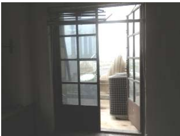
Door Left Open On Upper Floor
