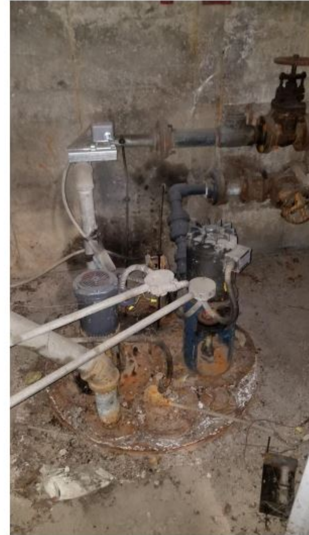
Fig. XX SW Fan room sump pumps
